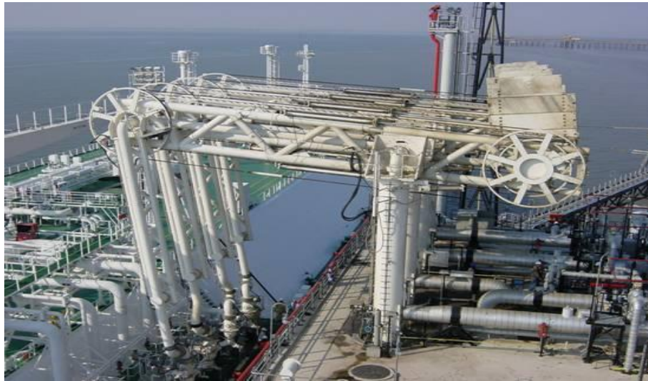
Figure 3 - Unloading arms at an LNG import terminal [5]
